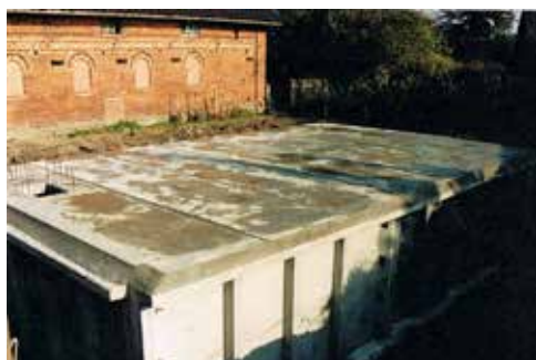
Her ses den underjordiske rentvandstank ved vandværket. Tanken kan indeholde 150.000 L rent vand.
