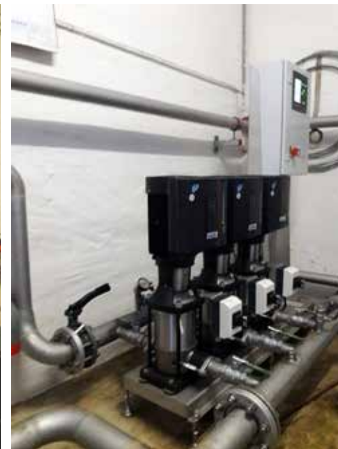
Her de nye pumper, som forsyner vandværkets brugere.
